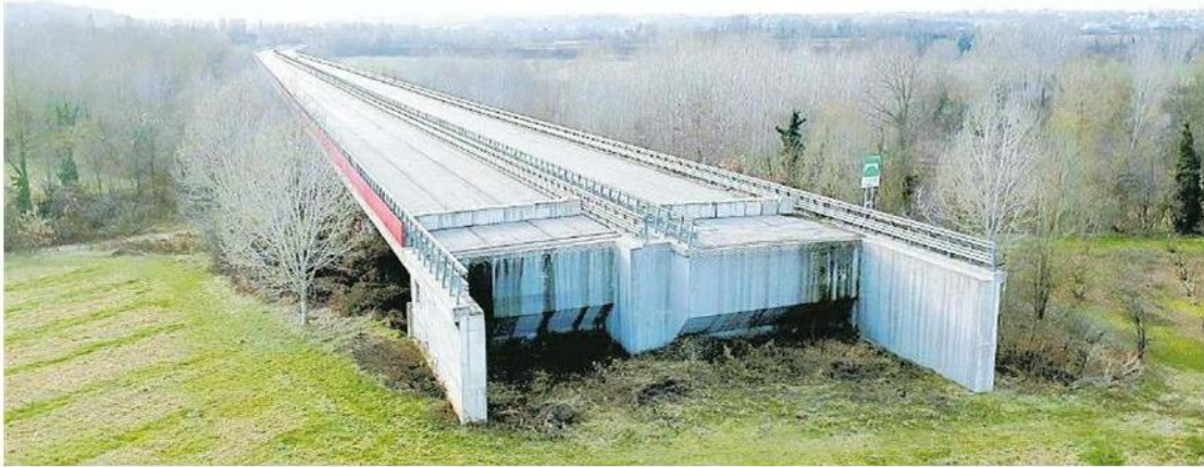
Ecco il moncone di autostrada alla periferia di Cherasco: lì muore la A33. Per completarla mancano 9 chilometri
