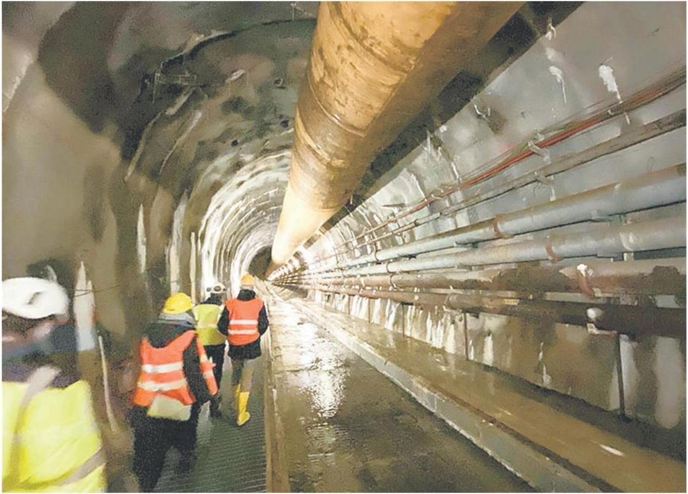
Il cantiere Tav di Chiomonte ha ripreso a lavorare nei mesi scorsi
