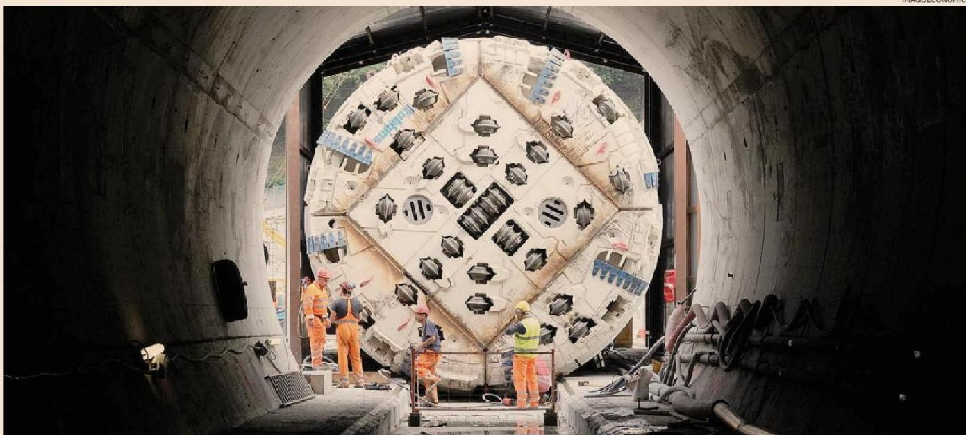
Grandi lavori. Una veduta del cantiere per la realizzazione del tunnel per la linea ferroviaria ad alta velocità tra Torino e Lione
